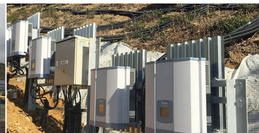
园区采用共185组台达RPI-M系列高效率、高抗候性户外型太阳能逆变器进行电力转换
